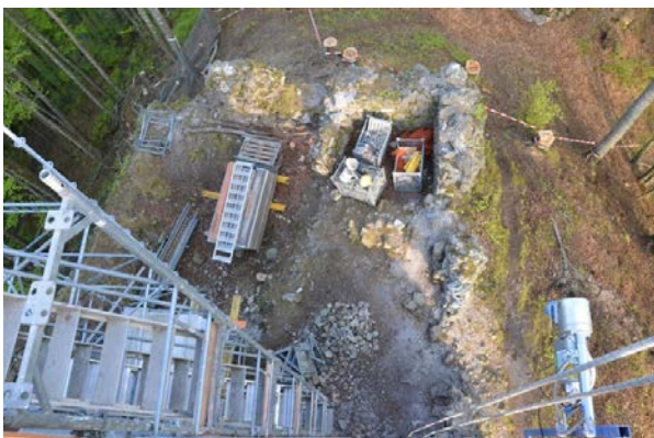
Anfangs November baute die Gerüstfirma das Baugerüst zurück und transportierte einen grossen Teil der Elemente ab. Einige Teile werden im Burghof gelagert, welche im Jahr 2022 zum Abschluss der Arbeiten am Wohnturm im untersten Bereich benötigt werden.
